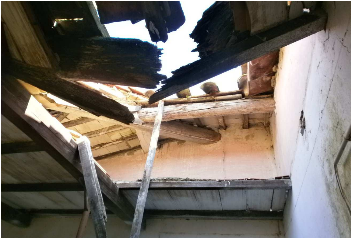
FOTO 22 – Il Poggiale I°- Vano n. 1 a P. Primo( a sx Loggiato) - controsoffitto e copertura crollata
