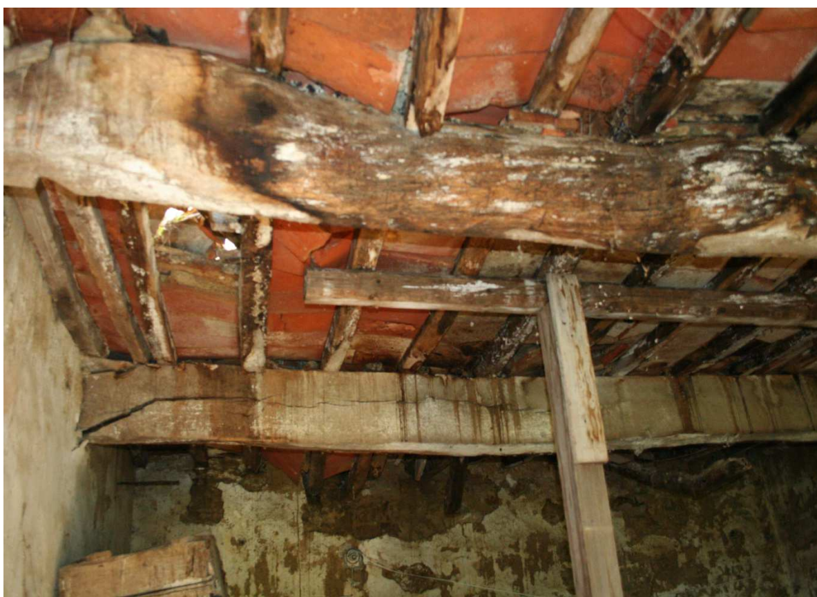
FOTO 16 – Il Poggiale I° - Vano n. 9 (a dx scale) a P.Terra – Solaio in dissesto puntellato
