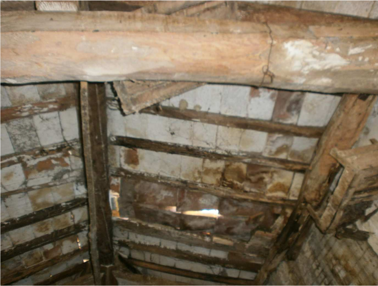
FOTO 37- Poggiale I° - Locale Colombaio o Altana a 2° P. Copertura pericolante
