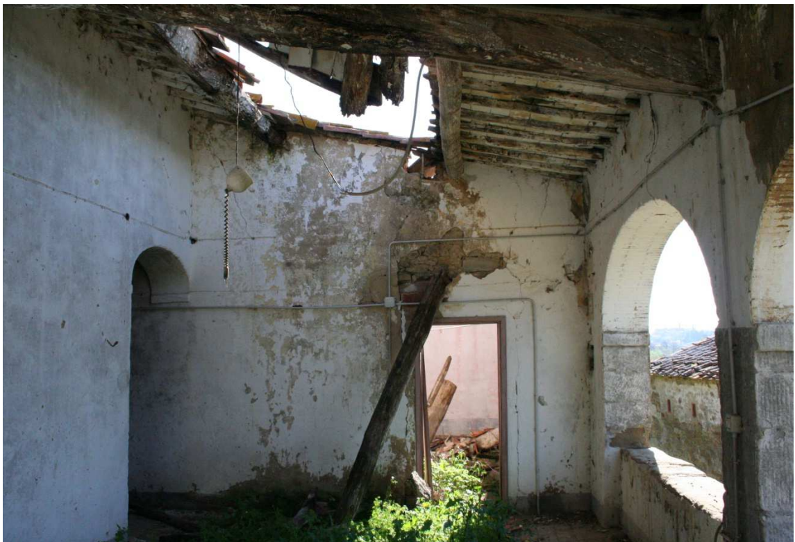
FOTO 20- Il Poggiale I°- Vano n. 6 a Piano Primo – Loggiato – Copertura crollata
