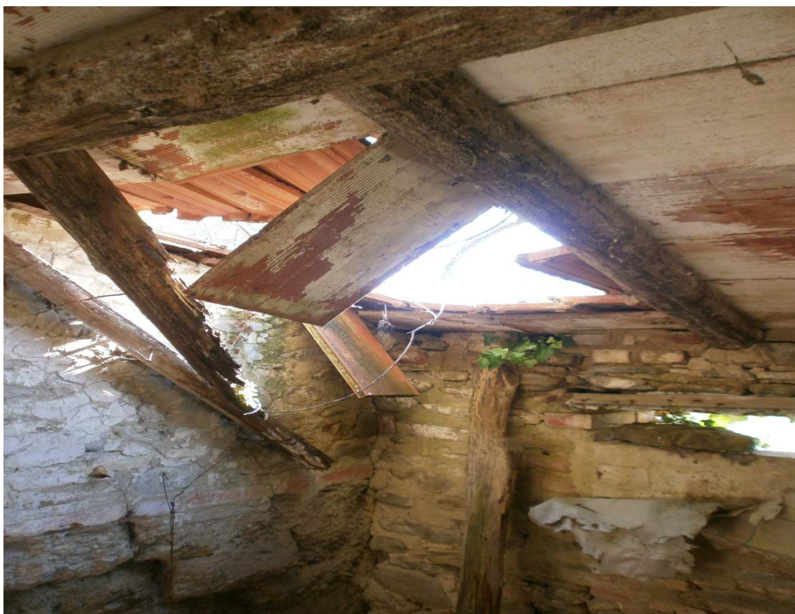
FOTO 18 – Il Poggiale I° - Vano n. 11 – Porcile esterno – Copertura crollata
