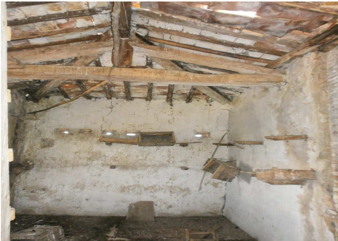
FOTO 36 – Poggiale I°- Locale Colombaio o Altana a 2° P. Copertura pericolante
