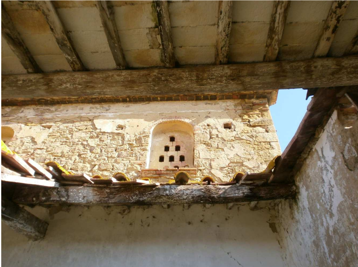
FOTO 31 – Poggiale I° - Vano n.10 a P. Primo – Tetto crollato
