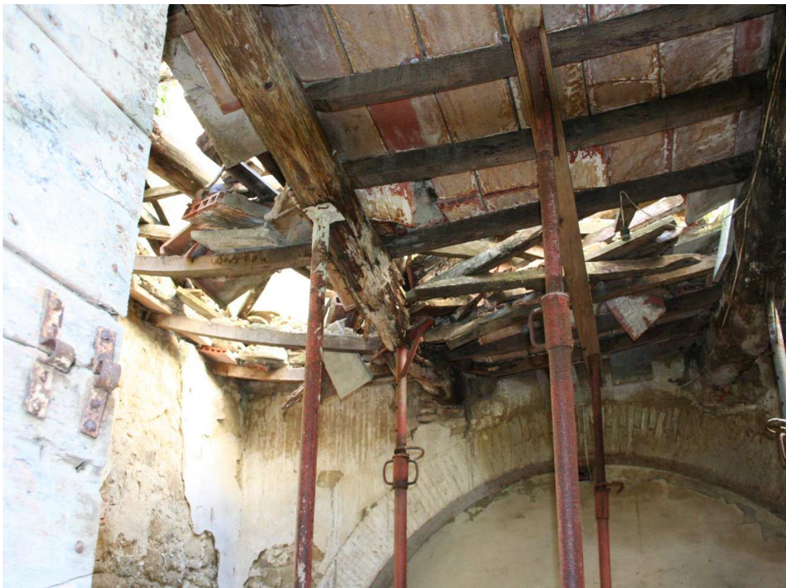
FOTO 17- Il Poggiale I° -Vano n. 10 a P. Terra – Solaio crollato
