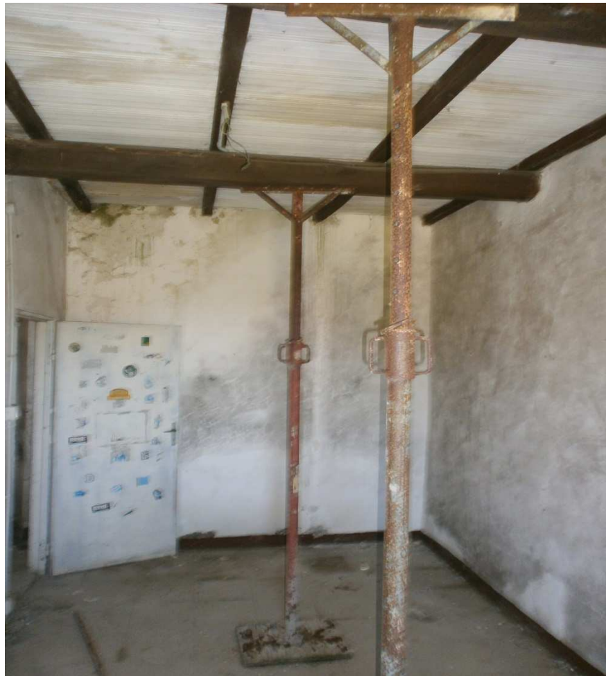
FOTO 24 –Poggiale I°- Vano n. 3-a P. Primo- controsoffitto in crollo
