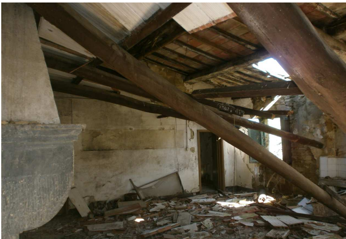
FOTO 26 – Poggiale I° -Vano n. 8 a P. Primo (Cucina) –Controsoffitto e tetto crollati –
