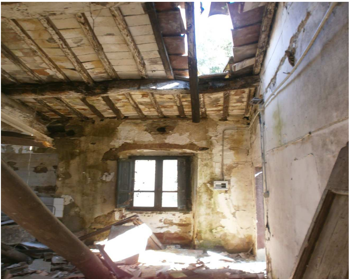
FOTO 28- Poggiale I° - Vano n. 8 a P. Primo (Cucina) – Controsoffitto e Tetto crollati
