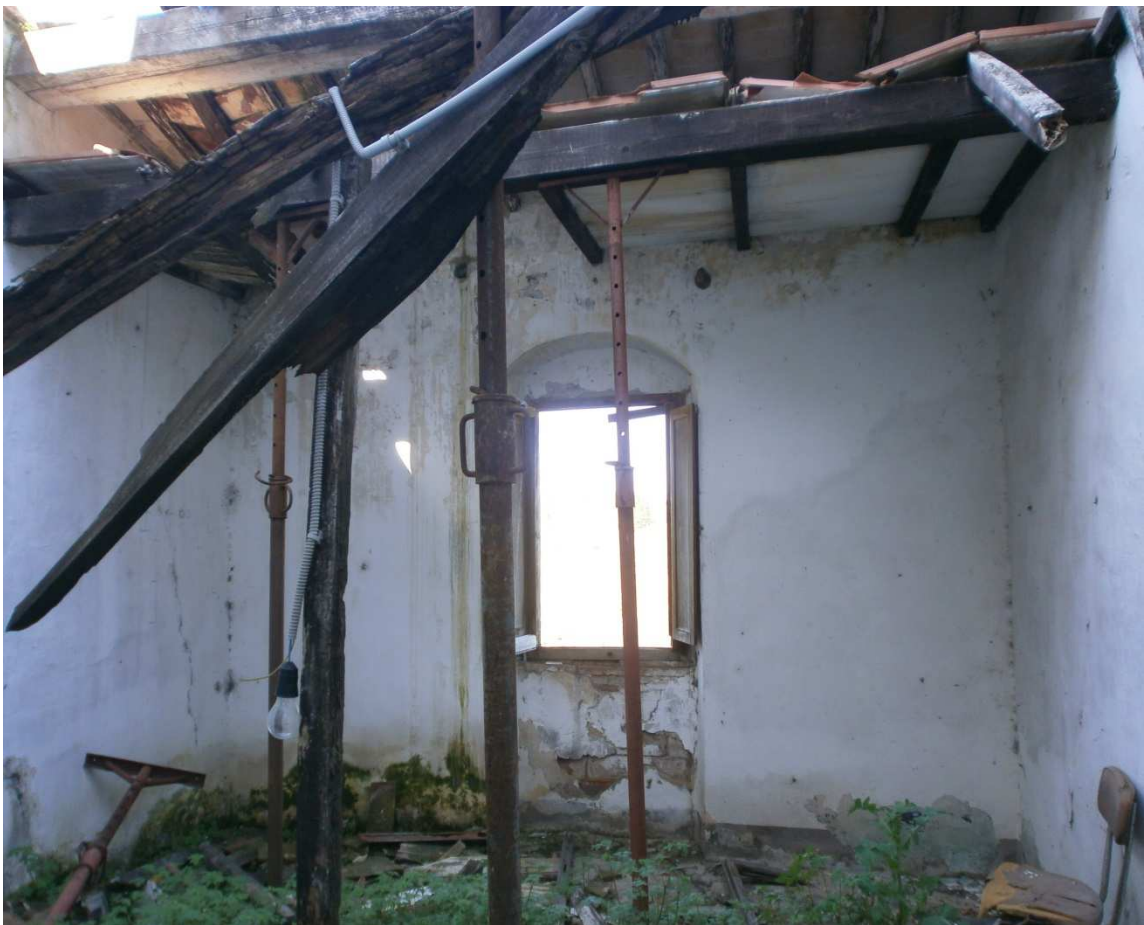
FOTO 30-Poggiale I° -Vano n. 9 a P. Primo- Tetto crollato e controsoffitto crollato
