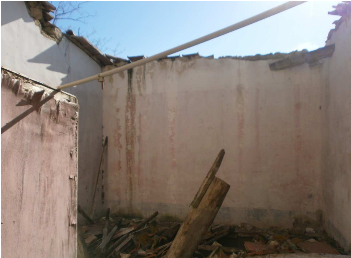
FOTO 32 –Poggiale I° - Vano n. 11 a P. Primo- Tetto crollato
