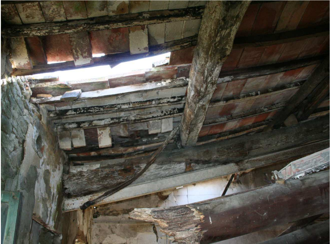
FOTO 27-Poggiale I° -Vano n. 8 a P. Primo (Cucina) –Controsoffitto e tetto crollati-
