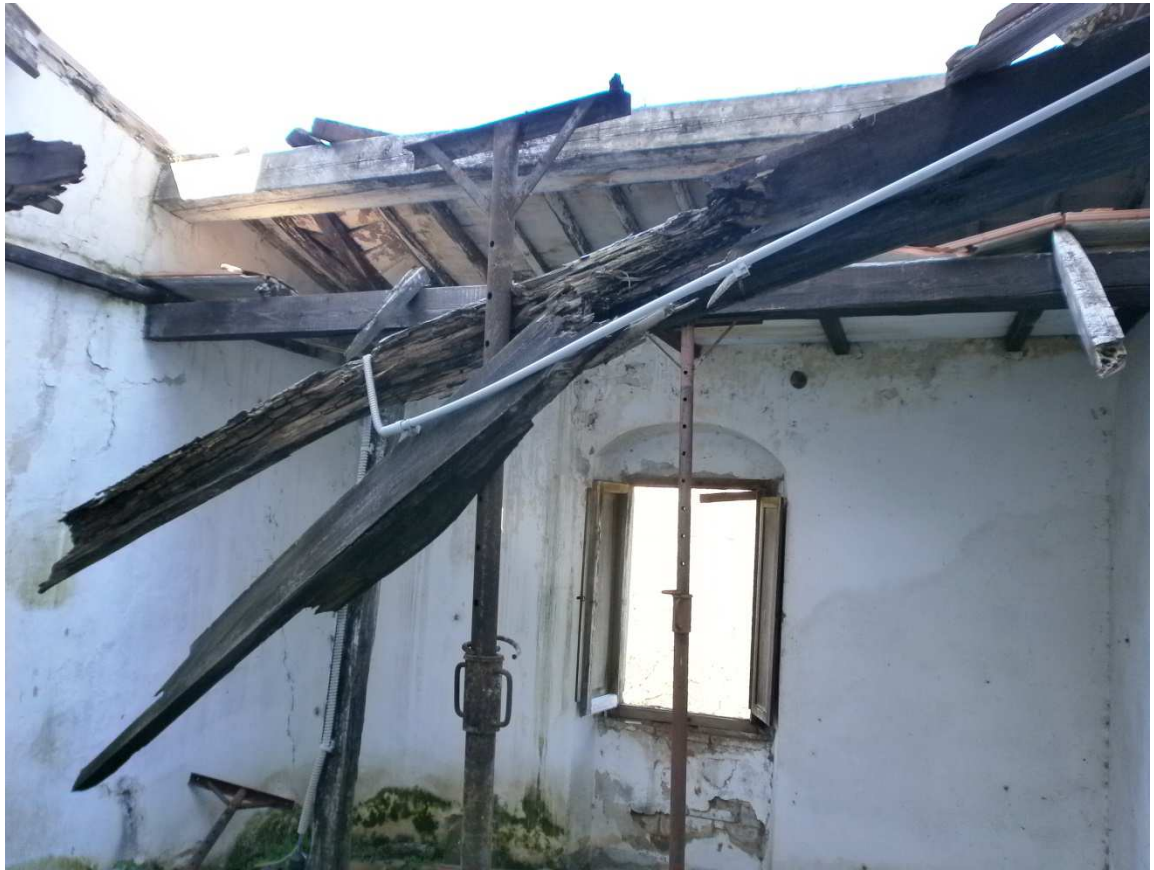
FOTO 23- Poggiale I° - Vano n. 2 a P .Primo controsoffitto e Tetto Crollato
