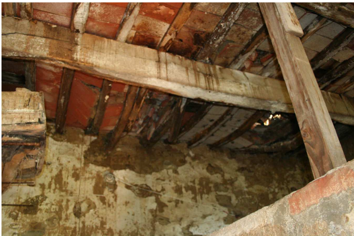
FOTO 15 – Il Poggiale I° - Vano n.9 (a dx scale) a P.Terra – Solaio in dissesto puntellato
