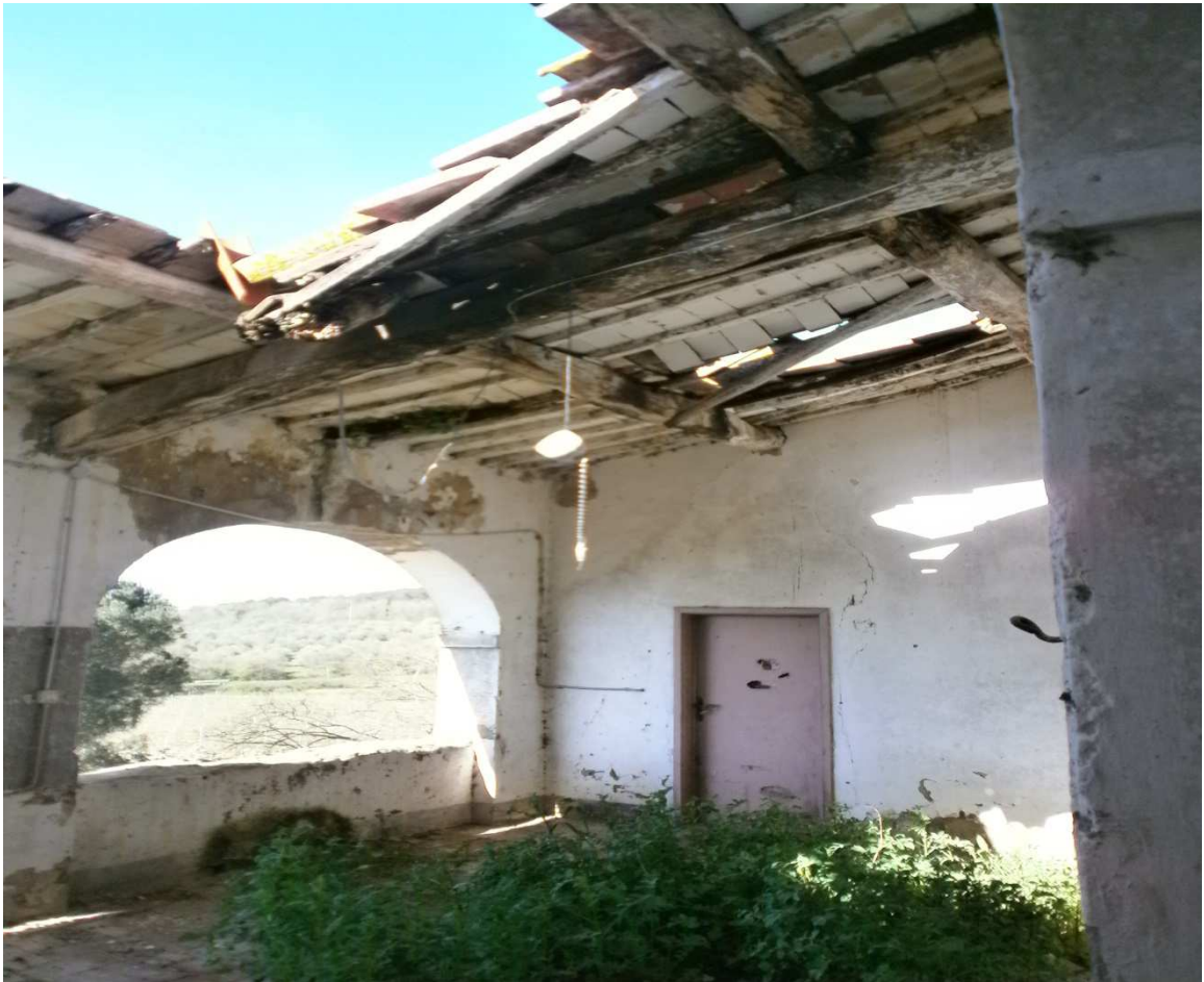
FOTO 21 – Il Poggiale I° - Vano n. 6 a P. Primo- Loggiato – Copertura crollata
