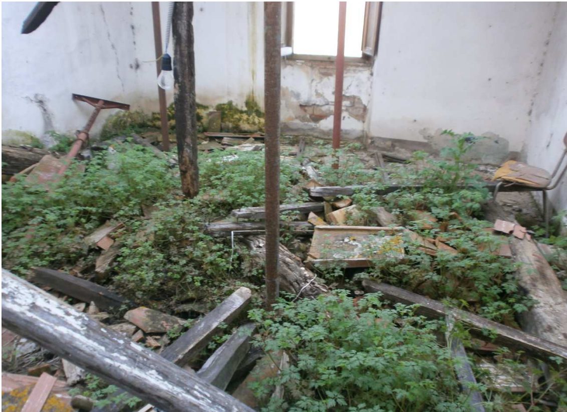
FOTO 29 –Poggiale I° - Vano n. 9 a P. Primo –Tetto crollato – accumulo detriti su solaio
